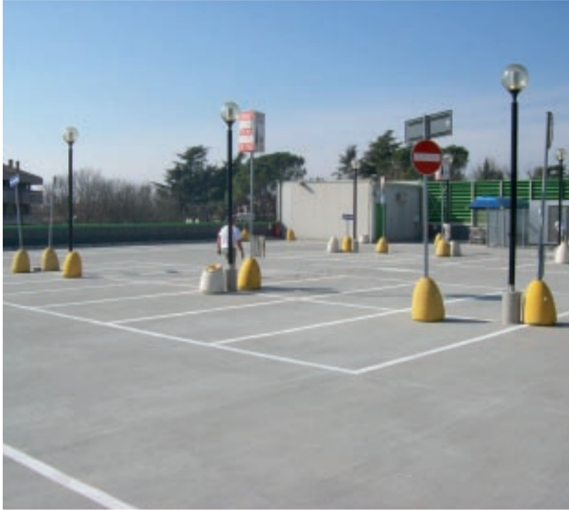
Das Coop Parkdeck nach der Sanierung mit KEMPEROL® BR. Die Fläche befindet sich auf dem Dach des Gebäudes, darunter liegen die Verkaufsräume.
