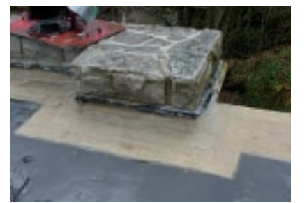
Kritische Übergänge zwischen unterschiedlichen Materialien wurden bei Restaurierungsarbeiten ‚flüssig‘ mit KEMPEROL® abgedichtet.
