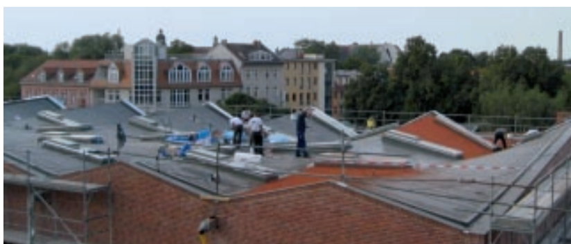
Die Abdichtung der Fläche erfolgte mit dem lösemittelfreien KEMPEROL® 2K-PUR (Foto: Holl Flachdachbau).
